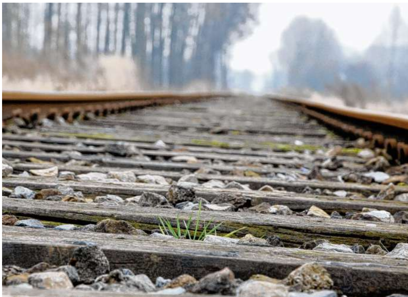
Ein zartes Pflänzchen: Das Versmolder Schienennetz liegt aktuell nahezu brach. Das soll sich in den nächsten Jahren ändern, wenn die Lappwaldbahn als Eigentümer die Infrastruktur ertüchtigen und für den Verkehr wieder attraktiv machen will. FOTOS: J. HERRMANN
